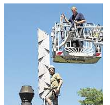
Die neue Sirene ist im Quartier Langacker montiert worden. zvg
