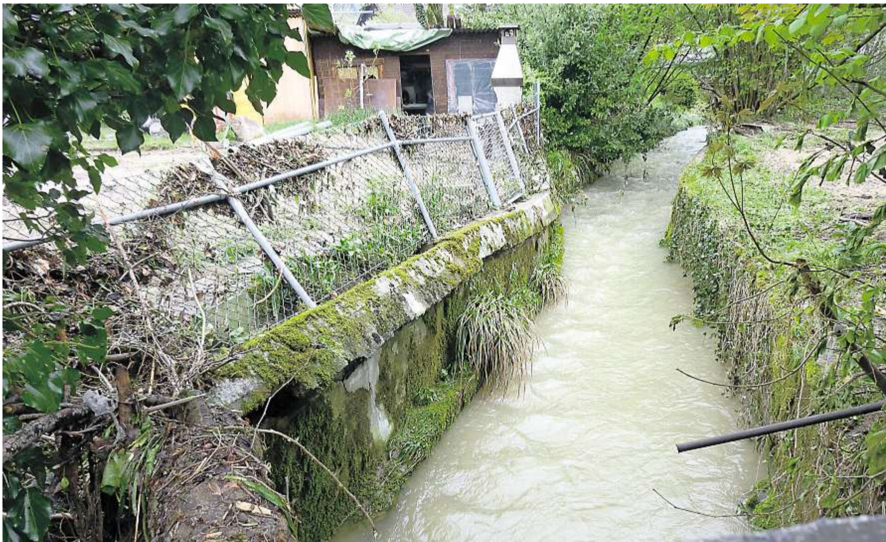
Durch das Schwemmholz staute sich der Dollikerbach in Meilen innert Kürze, das Wasser drückte den Zaun ein und riss eine kleine Holzbrücke mit sich. Bilder: Regine Imholz
